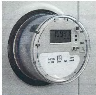
Contadores eléctricos Registran el consumo de energía eléctrica en kWh.
